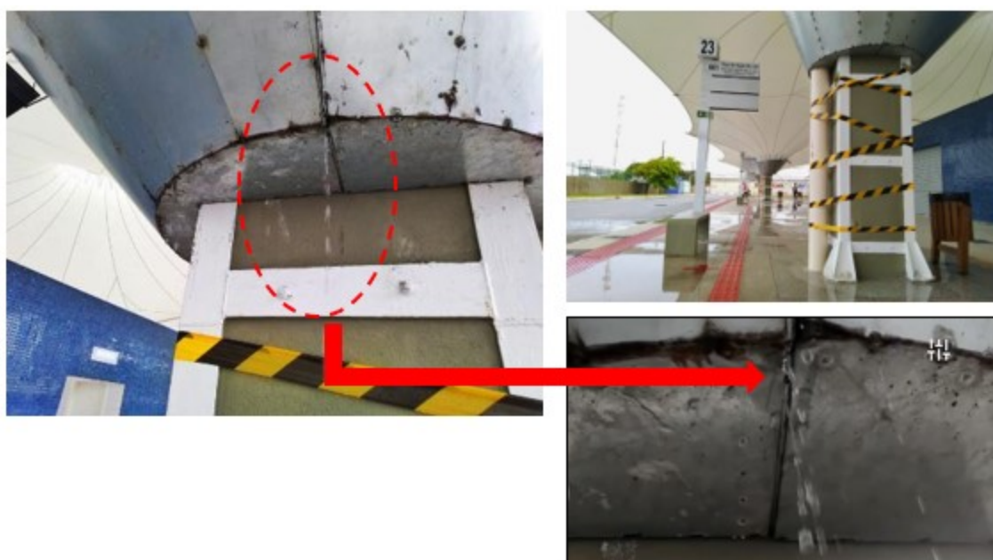
Foto 1 - Vazamento do sistema de drenagem da cobertura do terminal.
